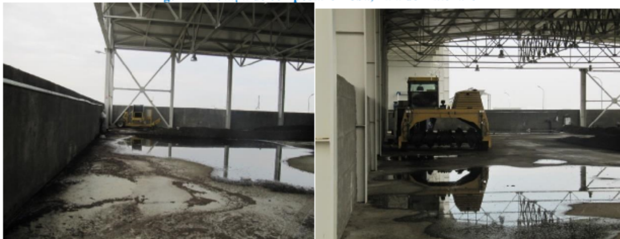
Figura 4-8 Stația de compostare Doba, hala de maturare
