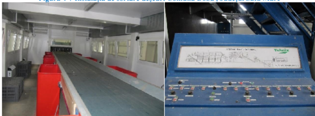
Figura 4-7 Instalația de sortare deșeuri Comuna Doba , Județul Satu Mare
